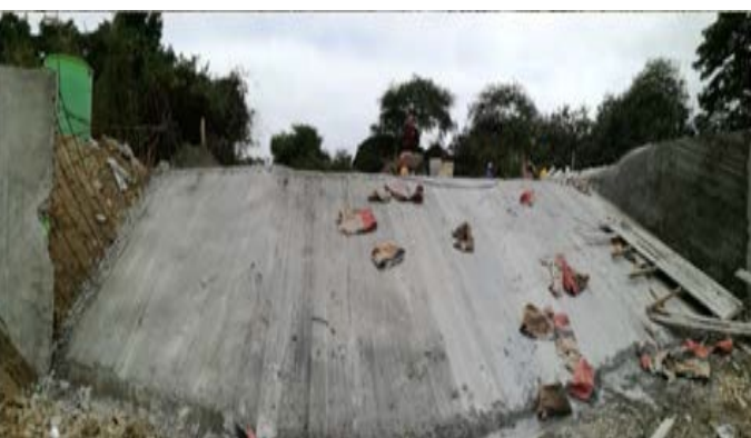
Fase de construcción de un dique de concreto en el río Manglaralto (foto: I. Fajardo).
