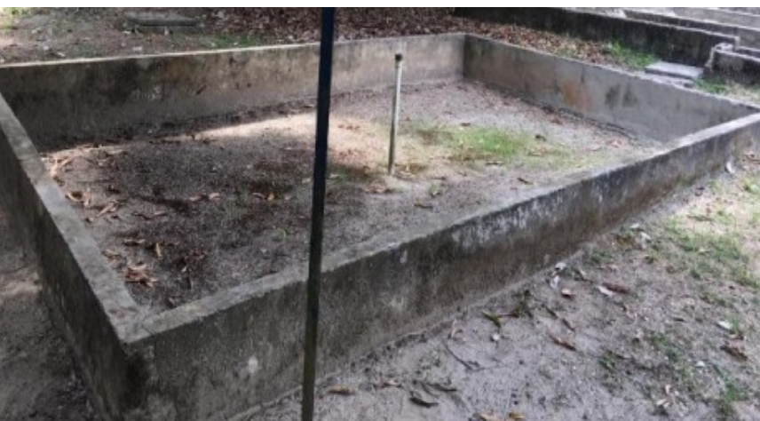
Infiltration trench N° 1 (photo: José Luis Navarro, 2020).
