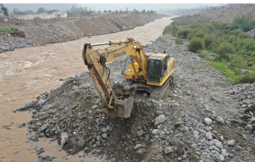
Intervenciones en el cauce del Rímac para mejorar la infiltración al acuífero (foto: Revista Perú Construye).
