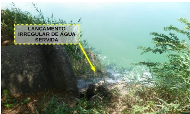
Irregular discharge of untreated sewage into Lagoa da Tarauca (photo: MPRN - Informação Técnica nº 088/2018).
